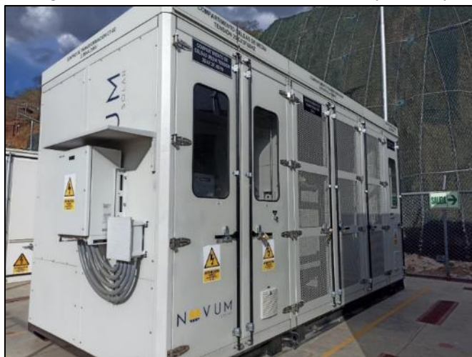
Figura 7: Centros de transformación (02 und)
