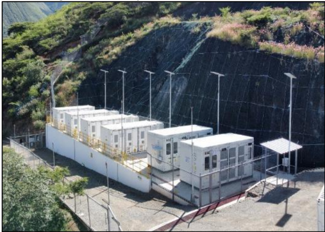
Figura 10: Proyecto BESS terminado
